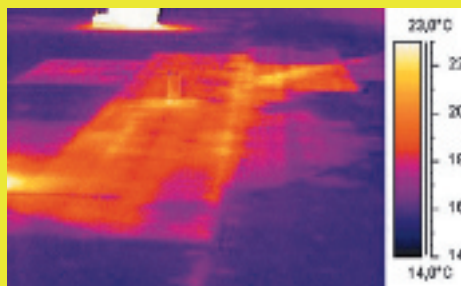
平屋根への水の侵入
