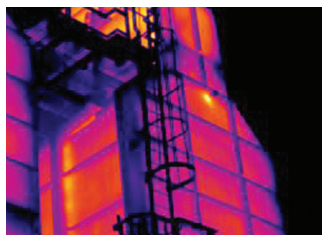
石油精錬所におけるガス漏れ
