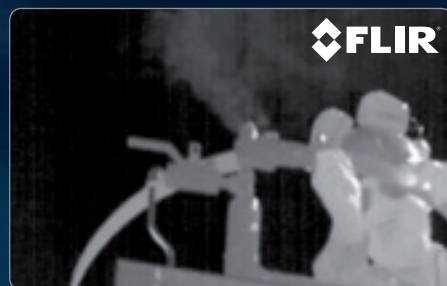
一酸化炭素漏れの光学ガス画像
