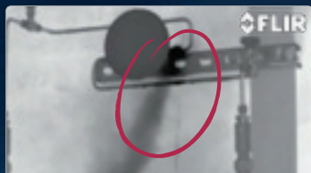
圧力計からの漏出
