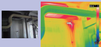
乾燥炉の有機溶剤漏れ確認
