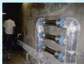
H 駅ターミナルビル 受水槽前に設置
