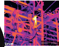
▲変電設備にて
