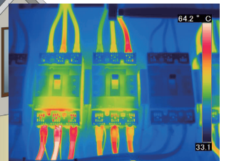
▲ブレーカーの発熱確認
