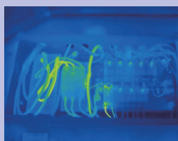
分電盤の温度確認
